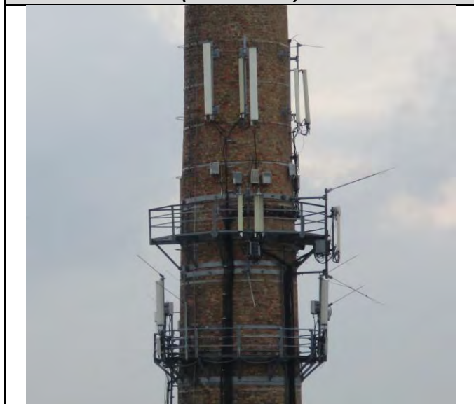
UOČENI IZVOR –Telekom, Telenor i Vip antenski sistemi (RADNIČKA 3)
