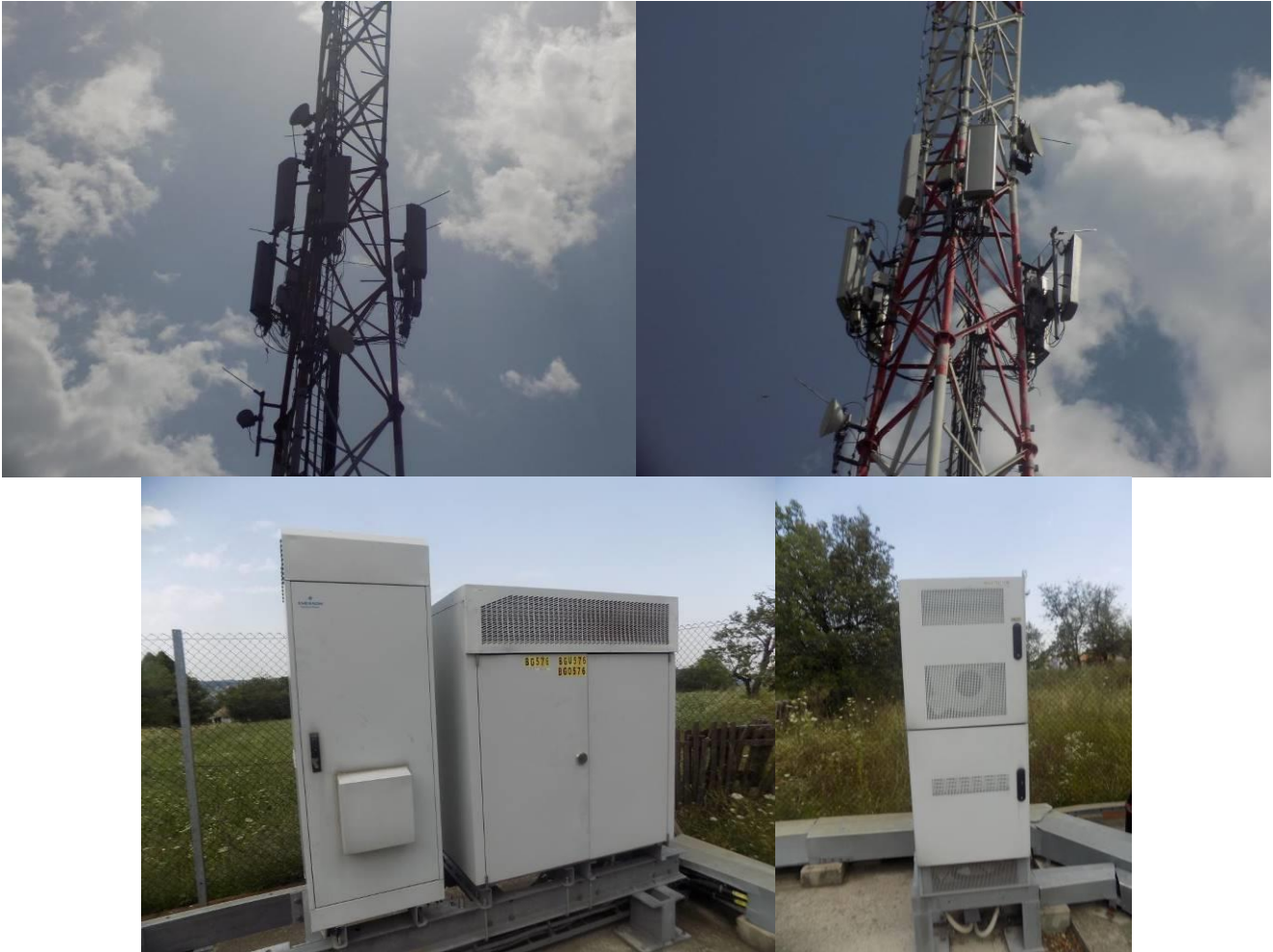
Slika 2.3. Fotografije antenskog sistema i bazne stanice operatera Telekom Srbija na lokaciji.
