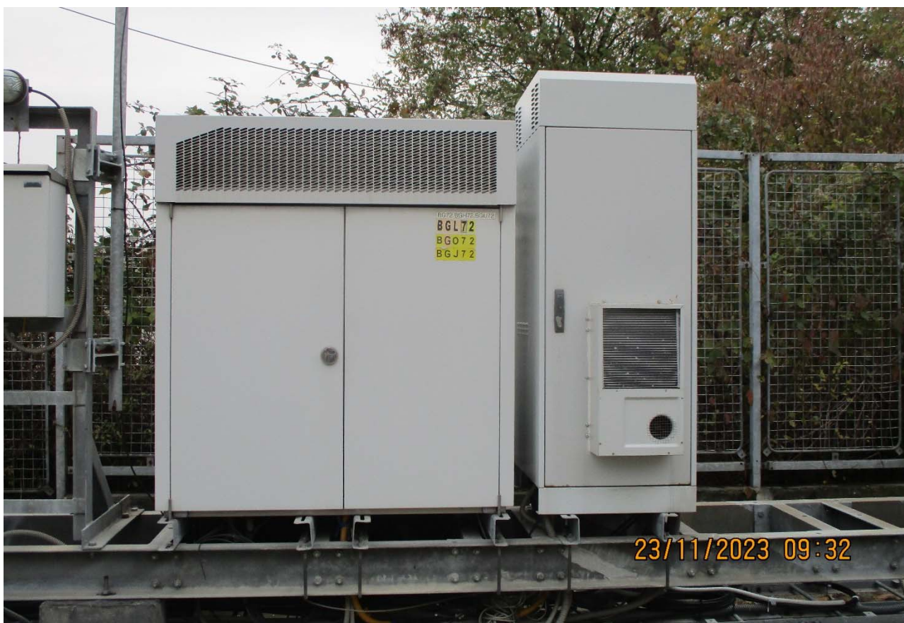
Slika 5 : Prikaz kabineta bazne stanice
