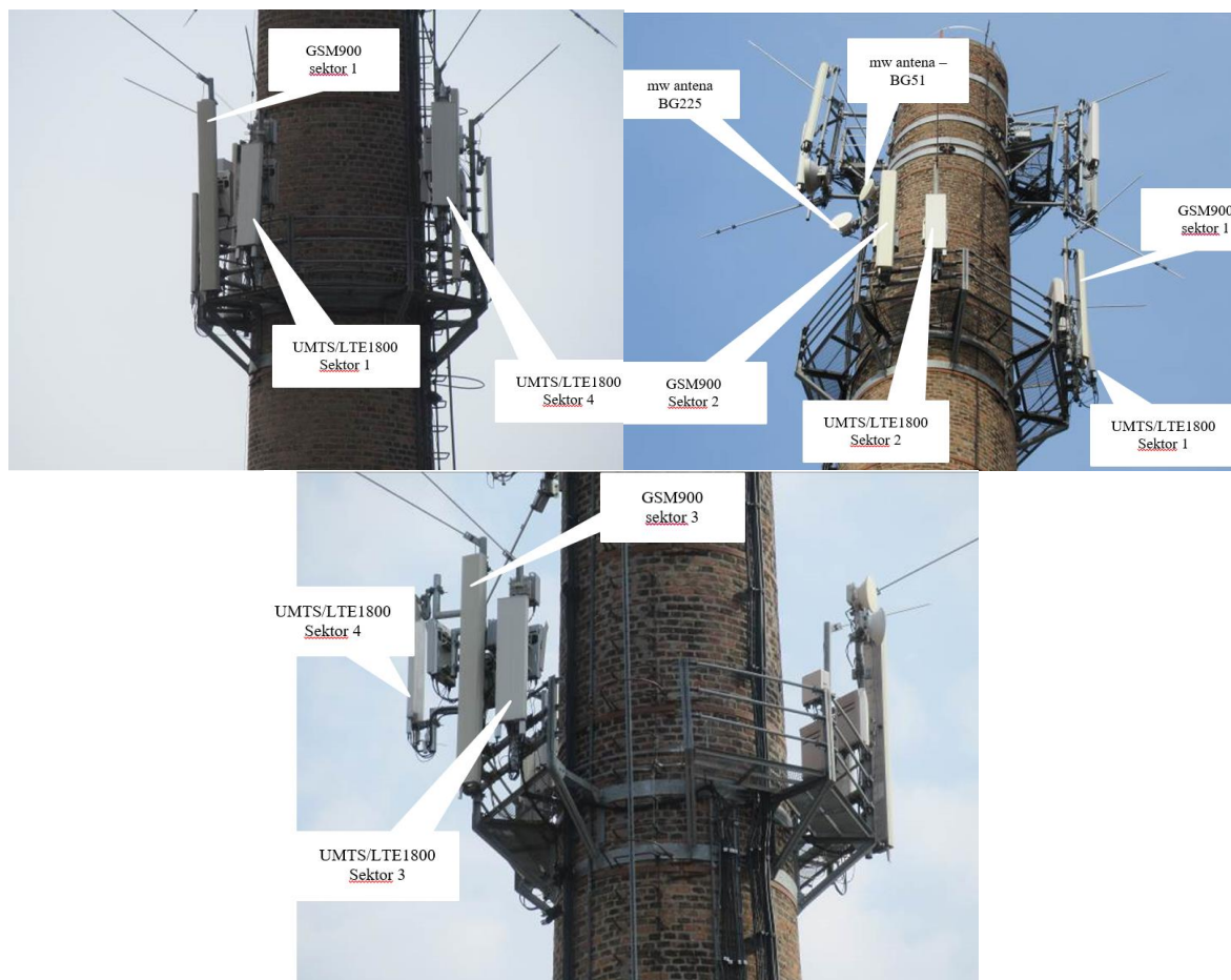
Slika 3.1.2. Antenski sistem na lokaciji
