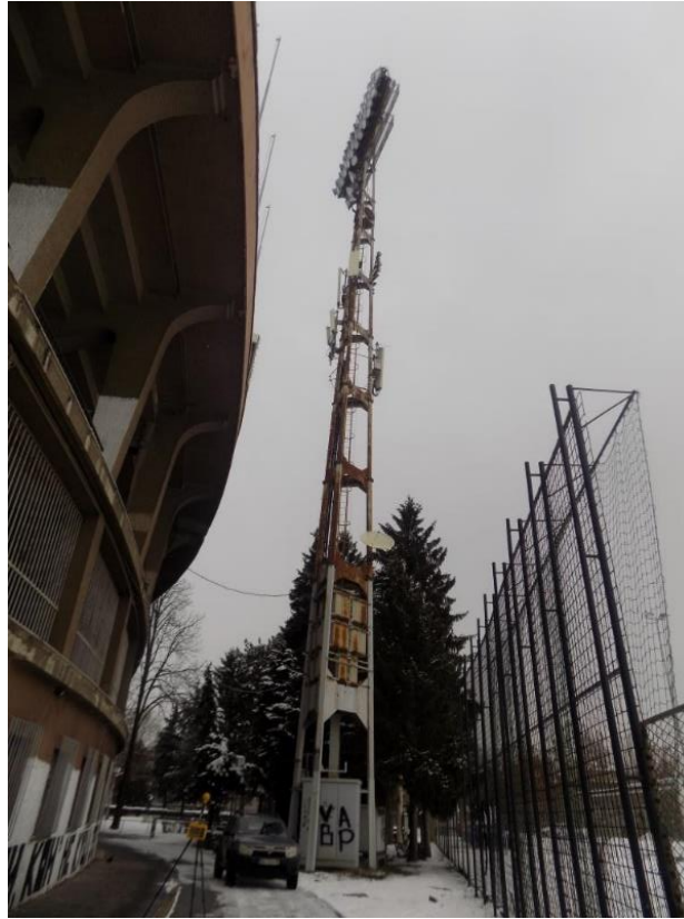
Slika 3.2. Reflektorski stub na kom je antenski sistem
