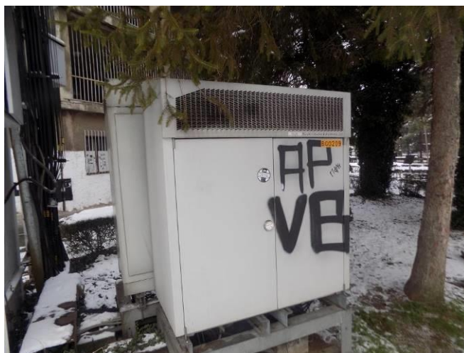
Slika 2.2b. Fotografija predmetne bazne stanice operatera Telekom Srbija
