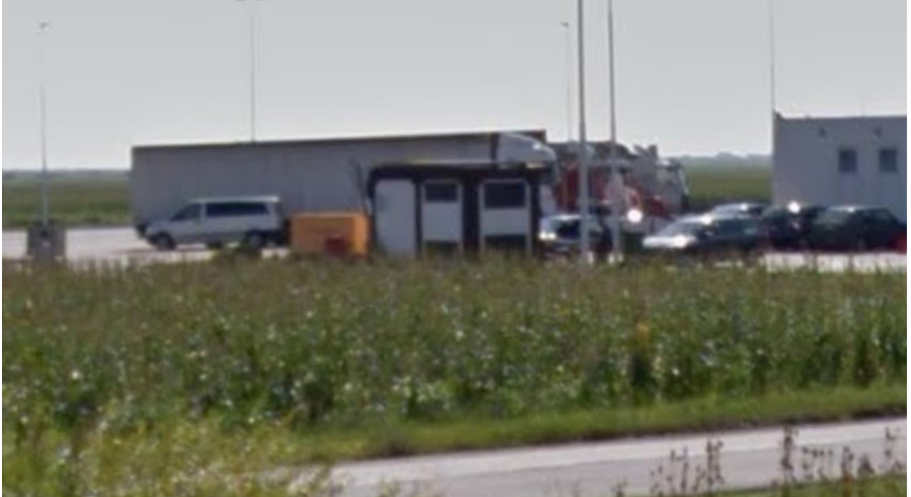
Слика 2. постојећи агрегат на локацији
