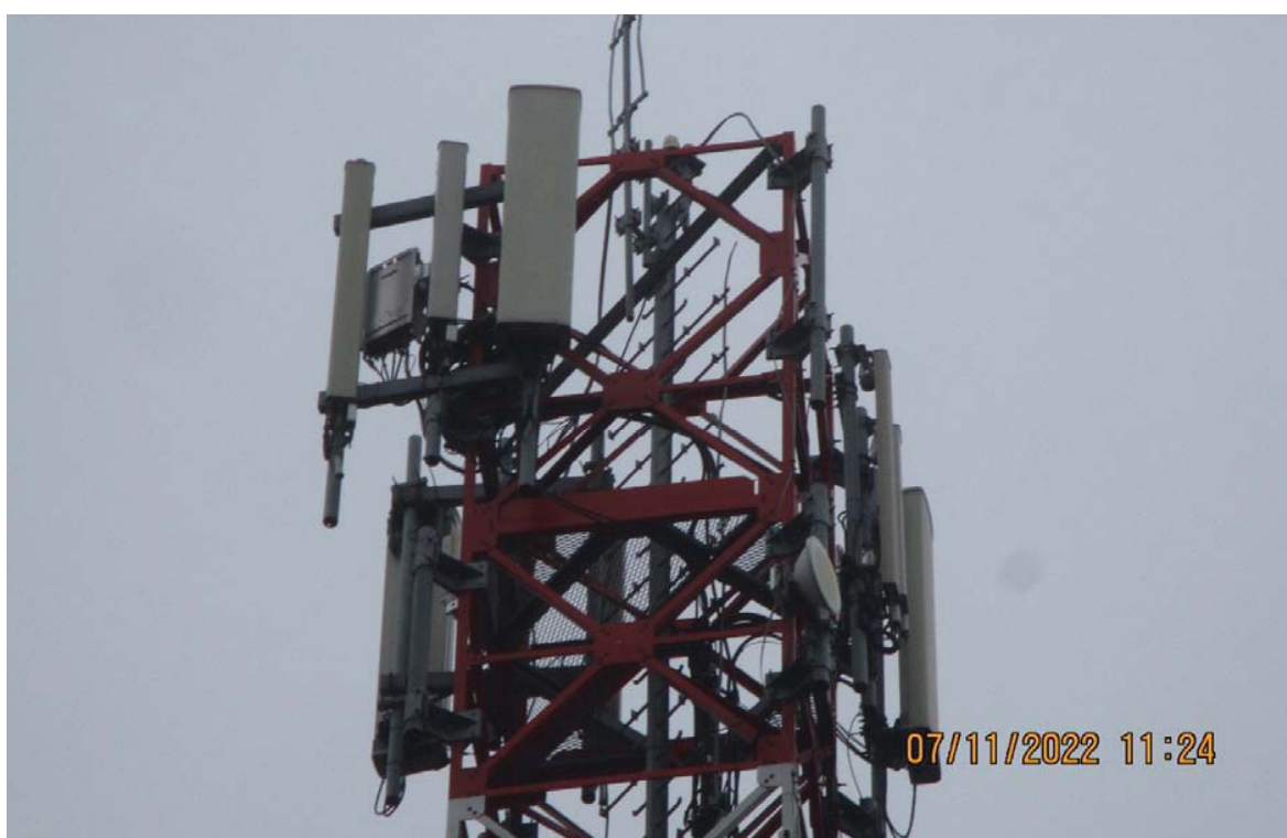
Slika 7 : Prikaz antena i radio modula sektora tri BS Veliko Polje operatora Telekom Srbija
