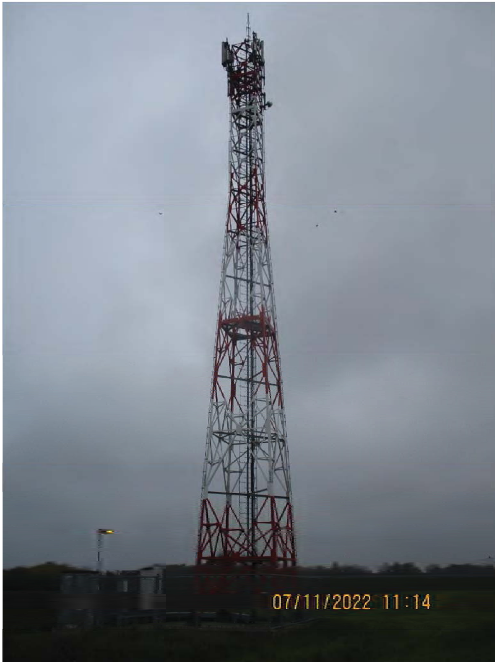
Slika 2.4 Objekat na kome je montirana predmetna BS
