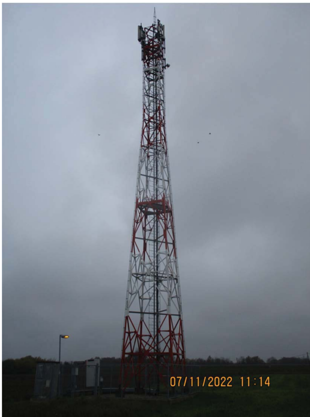
Slika 3: Prikaz stuba na kome se nalazi antenski sistem bazne stanice Veliko Polje, operatora Telekom Srbija
