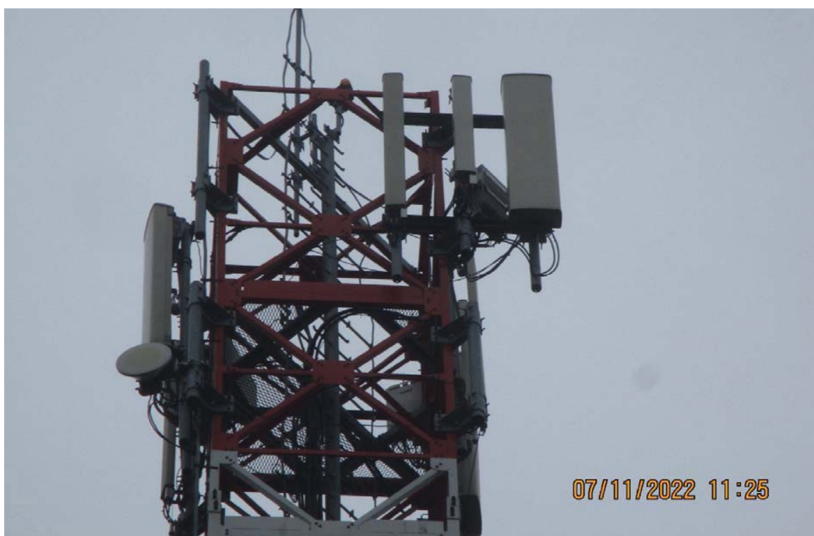
Slika 6 : Prikaz antena i radio modula sektora dva BS Veliko Polje operatora Telekom Srbija
