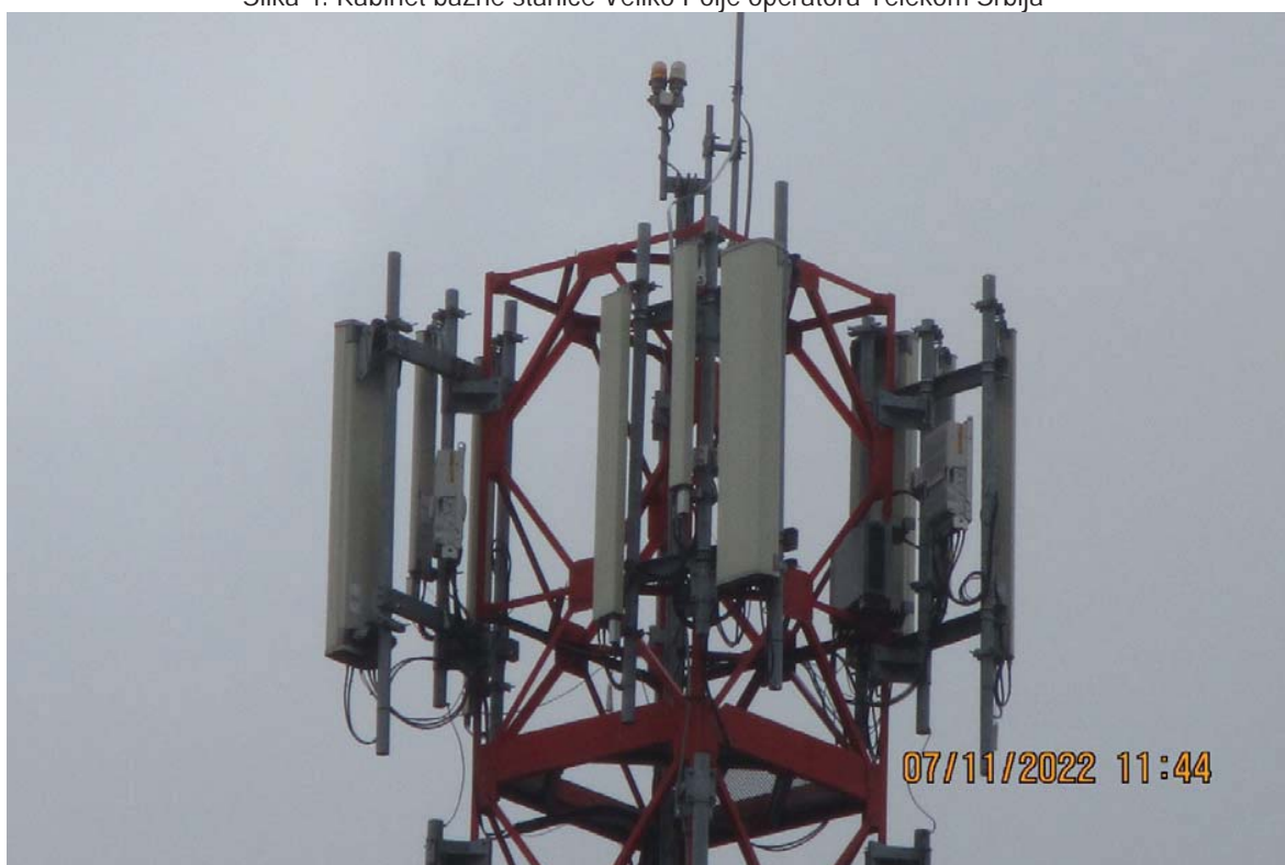
Slika 5 : Prikaz antena i radio modula sektora jedan BS Veliko Polje operatora Telekom Srbija
