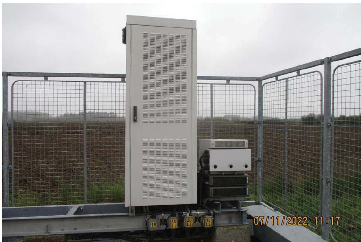
Slika 4: Kabinet bazne stanice Veliko Polje operatora Telekom Srbija
