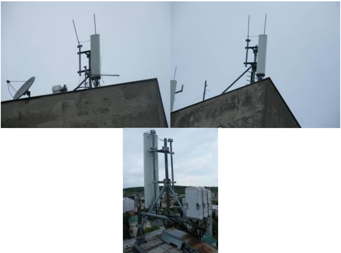
Slika 2.2.a. Fotografije antenskog sistema predmetnog izvora zračenja operatera A1 na lokaciji
