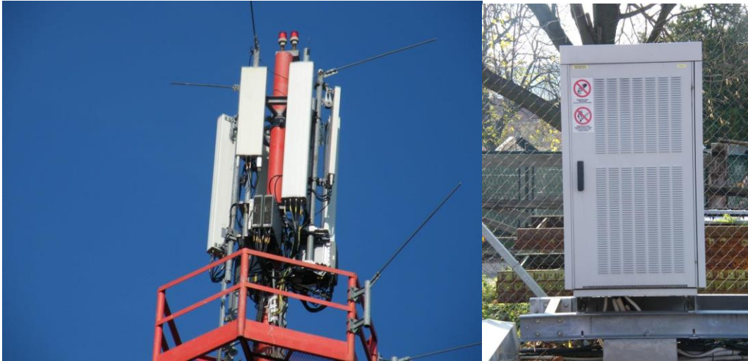
Slika 3.1.2.: Fotografije antenskog sistema i bazne stanice predmetnog izvora zračenja operatera A1 na lokaciji.
