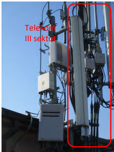
UOČENI IZVOR – Telekom antenski sistem (BEOGRAD,KARAĐORĐEVA 65)
